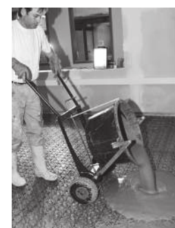
Utilisation du dispositif de déversement
