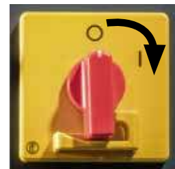
Einschalten des Hauptschalters
